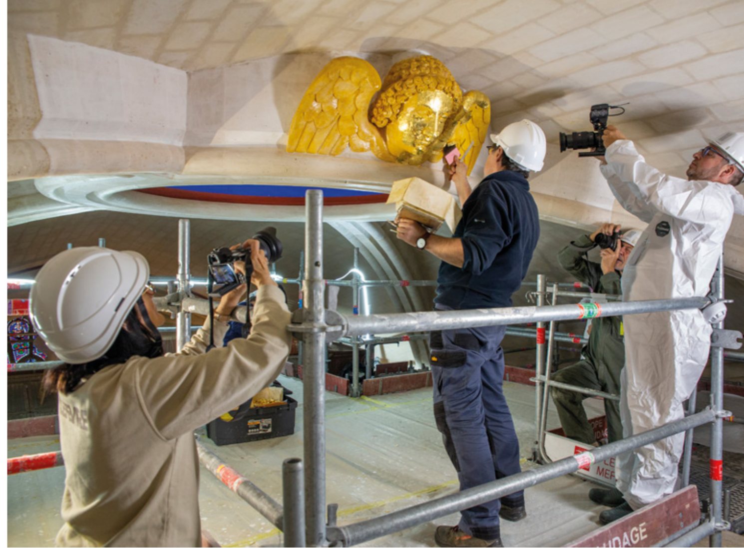
Doreur ornementiste travaillant sur le chantier de restauration de la cathédrale Notre-Dame de Paris. © Olivier Culmann / Tendance floue pour Geste/s magazine
