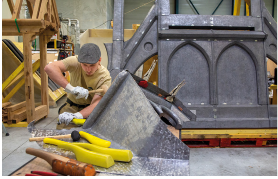
Atelier des couvreurs du patrimoine bâti travaillant sur la réfection de Notre-Dame de Paris. © Olivier Culmann / Tendence floue pour Geste/s magazine
